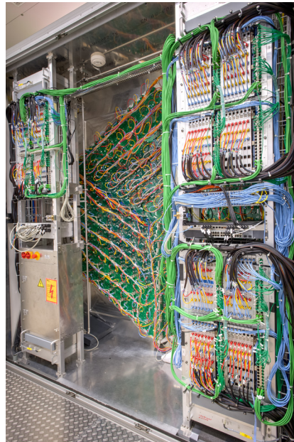
Rückansicht von FlashCam mit Elektronikracks und Verkabelung.
